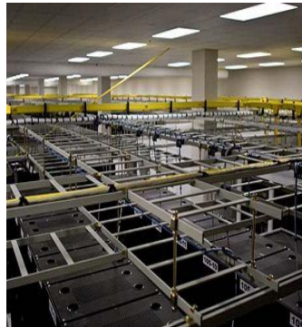
2. Metro Data Center (Atlanta) 92,000 sqm
